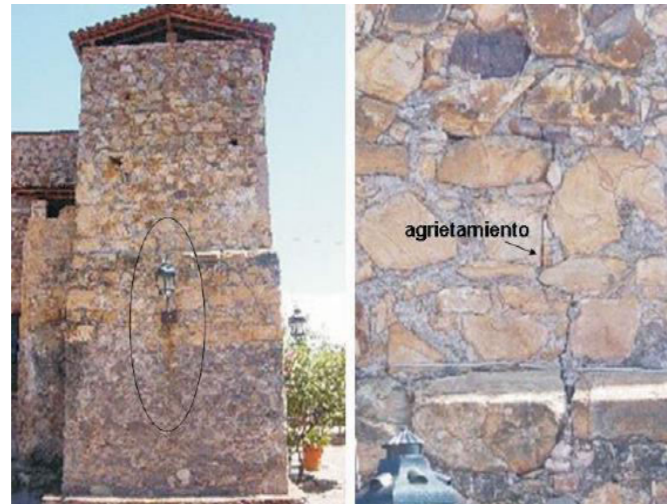
Imagen 19.- Agrietamiento en la torre del campanario de la Iglesia de la ciudad de Huetamo, fuente: Ciencia Nicolaita No.49, Pág. 167, en línea en: [http://goo.gl/4rgvsJ], octubre de 2014.
