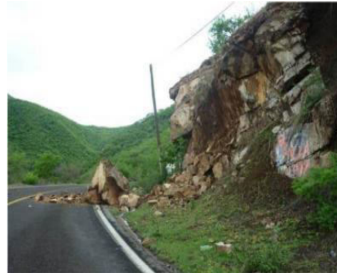
Imagen 14.- Carreteras afectadas por derrumbes. (2013-08-27); fuente: Cambio de Michoacán, foto: Ángel Ramírez Ortuño en [http://www.cambiodemichoacan.com.mx/nota-205115], agosto de 2014.
