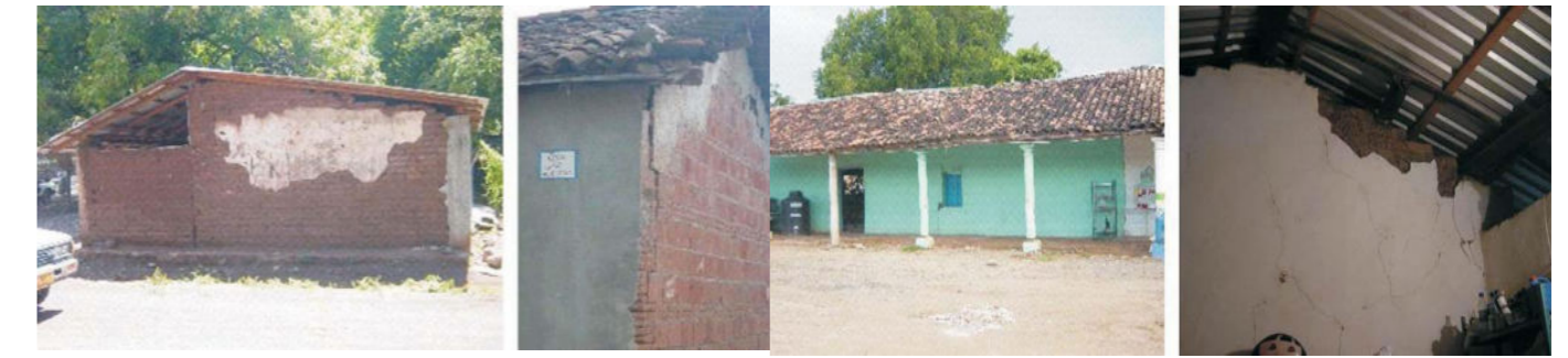
Imagen 7.- Los sistemas constructivos típicos de las casas de la región de Huetamo sufren estragos tras la presencia del sismo del el 11 de agosto del 2006 registrado a las 9:30:41, Fuente: Jorge I. Cruz Díaz y Jorge Ruiz García, Facultad de Ing. Civil, UMSNH, edición electrónica, pág. 9, en [http://goo.gl/4rgvsJ], 28 de julio de 2014
