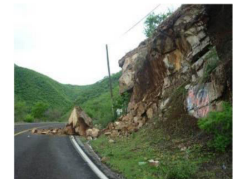
Imagen 63.- Carreteras afectadas por derrumbes. (2013-08-27); fuente: Cambio de Michoacán, foto: Ángel Ramírez Ortuño en [http://www.cambiodemichoacan.com.mx/nota-205115], agosto de 2014.
