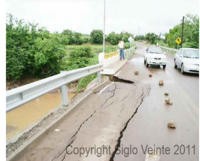
Imagen 15.- El reblandecimiento de la parte inferior del puente por el inmenso caudal de agua a causa de los torrenciales aguaceros, ocasionó una falla en su estructura superior, Fuente: MAX, en línea en [http://sigloveinte.com.mx/?p=5138], octubre de 2014.
