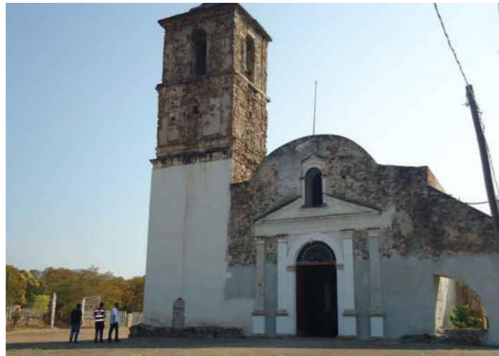
Imagen 8.- Vista de la fachada de la iglesia tras el sismo de 6.1, ocurrido el jueves 15 de noviembre, fuente: Noventa Grados, "Se registran 4 sismos en Michoacán", Edición Electrónica, en [http://goo.gl/29vK3O], 28 de julio de 2014.
